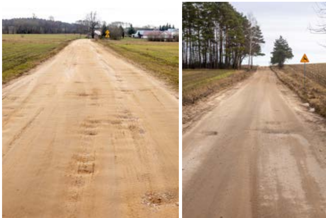
Dzięki Powiatowi Sokólskiemu drogi Budno - Cieśnisk, Kizielany - Gabrylewszczyzna i Kumiałka - Rudawka już niedługo nie będą tak wyglądać
